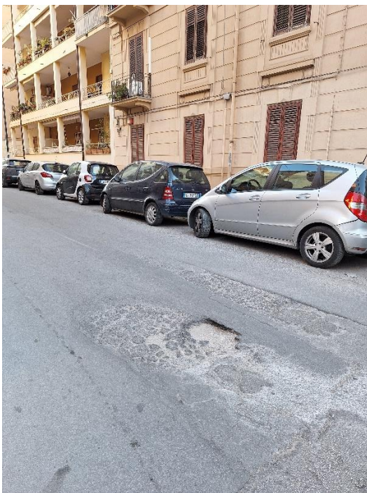
buche con fessurazione depresse
