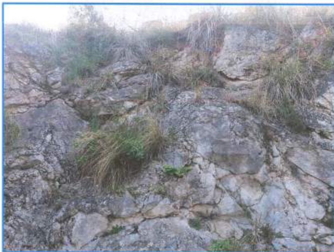
Fig. 3 - Particolare dei blocchi instabili sulle scarpate incombenti sulla via Ruffo di Calabria
