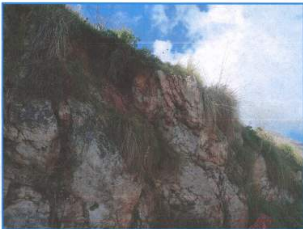
Fig. 4 - Particolare dei blocchi instabili sulle scarpate incombenti sulla via Ruffo di Calabria
