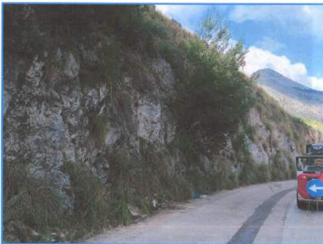
Fig. 2 - Vista di un tratto di scarpata incombente sulla via Ruffo di Calabria
