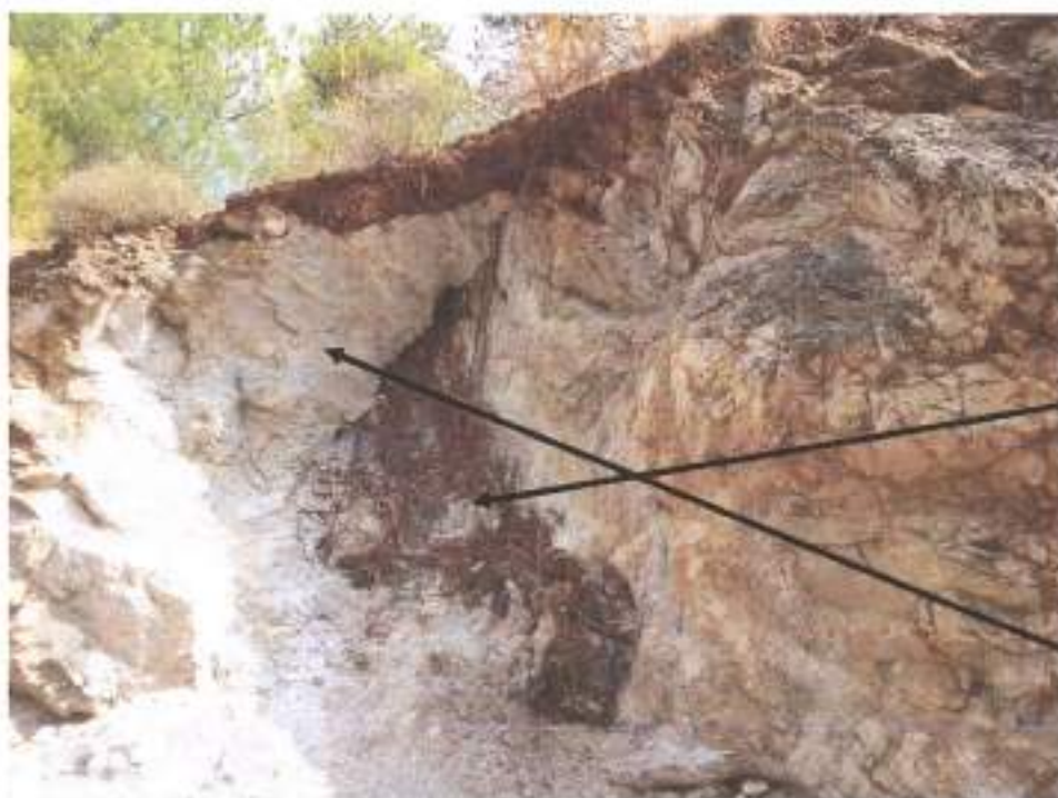
(Foto 5) Nicchia distacco causata dalle spinte degli apparati radicali
