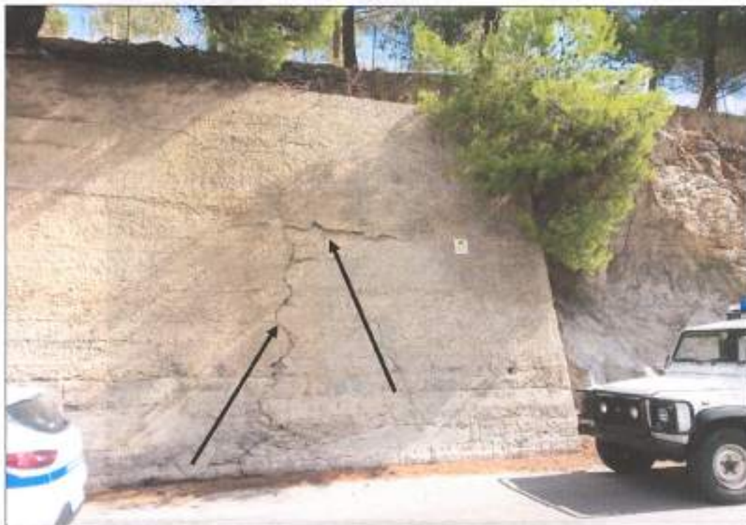
Foto 7 - Fratture originate da spinte a tergo del muro di sostegno da parte delle radici delle alberature sovrastanti il muro stesso
